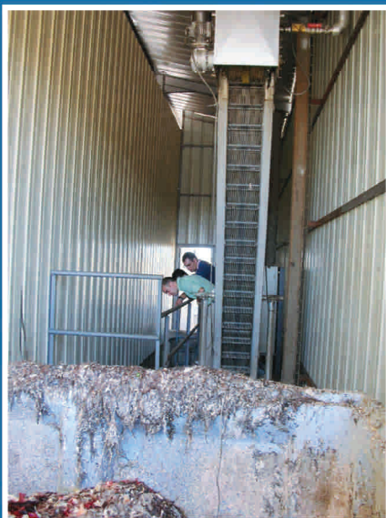
Separación de sólidos previa al pozo de bombeo
