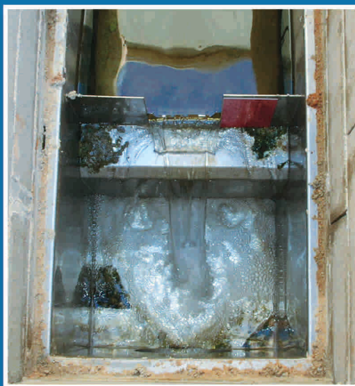
Efluente final. Calidad óptima.
